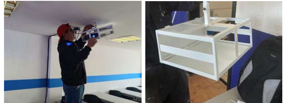
Figura 44 Fabricación y colocación de soportes para infocus en aulas norte y sur del instituto
